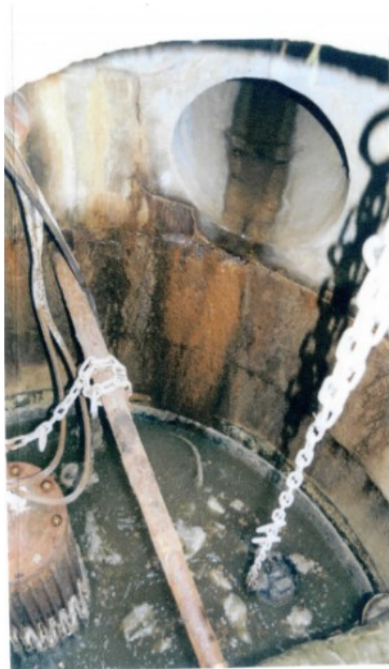
Bild 2: Pumpwerk Lindkirchen - RÜ 10
